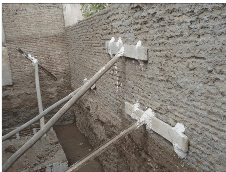
شکل ۸: روش کاملاً نادرست اتصال تیرک به دیوار ساختمان همسایه
