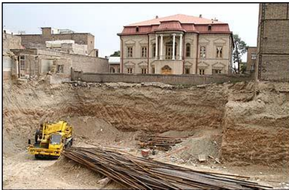
شکل ۵: گودبردای بدون حفاظ در مجاورت یک ساختمان قدیمی
