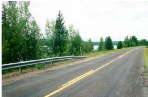
تصویر ۱۰- پوشش ناکافی طولی گاردریل در مسیر
