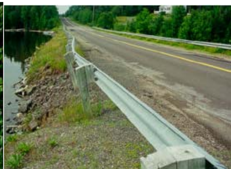
تصویر ۱۱- آب شستگی شانه راه و عدم ایستایی گاردریل
