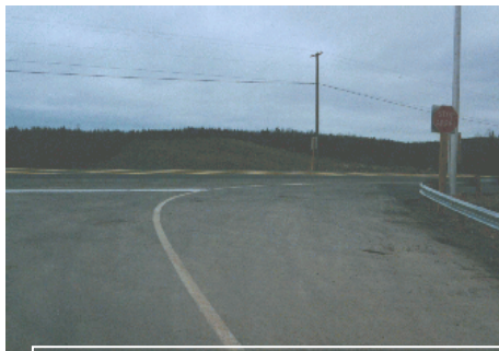
تصویر ۲- فاصله زیاد و نامناسب تابلوهای ایست در رمپ خروجی (راه ۲۵)
