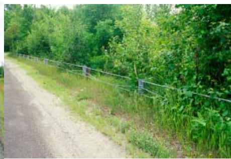
تصویر ۹- کابل‌های شل شده حفاظ کابلی
